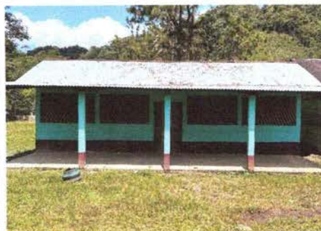
MUESTRA EL TECHO DE LA COCINA EN MAL ESTADO
