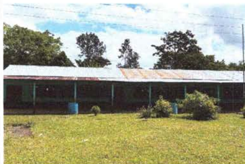
Muestra el techo del modulo 2 y el mal estado de las láminas
