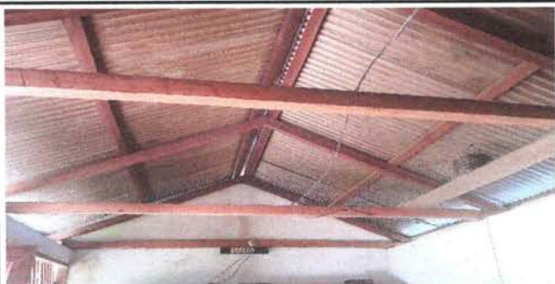
MUESTRA LA ESTRUCTURA DE MADERA DE LA PARTE INTERNA DE LA COCINA EN DETERIORO.
