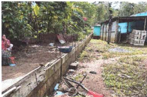
muestra el muro perimetral inconcluso
