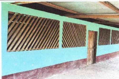
MUESTRA LA PARTE FRONTAL DE LA COCINA CON PUERTA DE MADERA Y LA ESTRUCTURA DE MADERA CON DETERIORO
