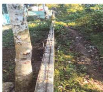
muestra el muro perimetral inconcluso
