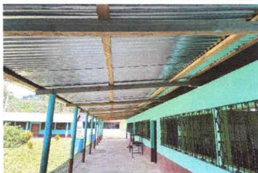
fotografía que muestra el deterioro de la estructura de madera
